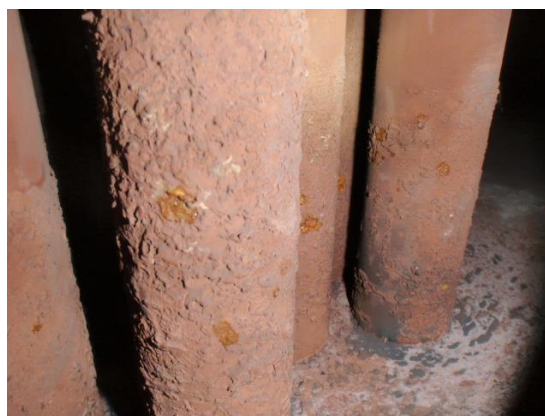
ブロー不足によるチューブ腐食
