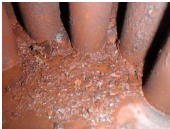
ブロー不足による缶内スラッジ蓄積
