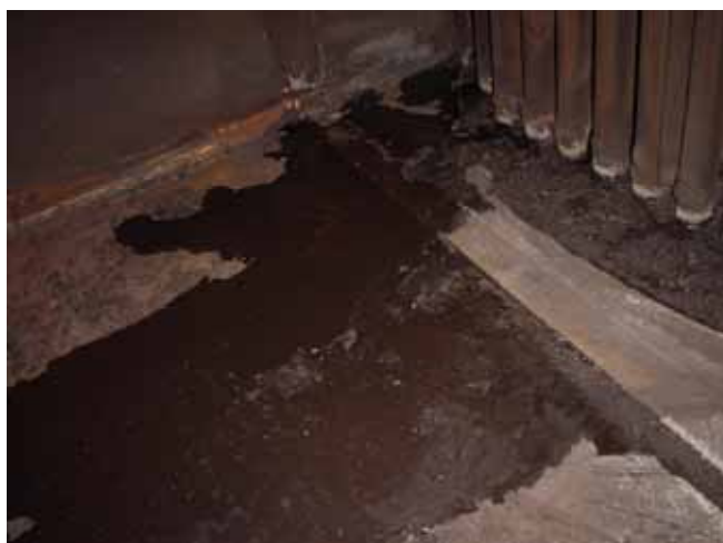
漏水時の状況
