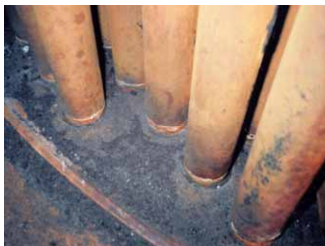
伝熱管損傷例 - 2
