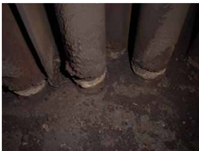
伝熱管損傷例 - 1
